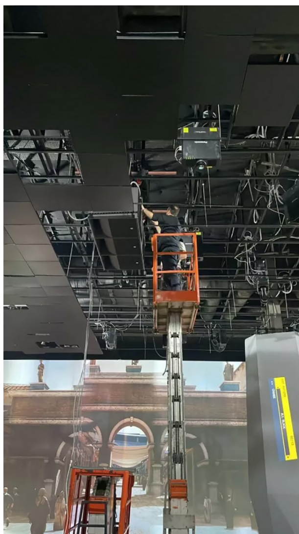
エフェソス・ミュージアムでイマーシブ体験を実現するために、75台の5XTスピーカーが天井と壁の異なる高さに設置されました。
