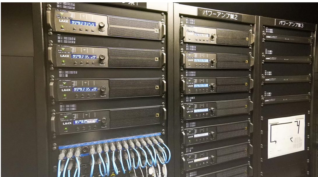
音響室に設置されたアンプリファイドコントローラー：LA4X × 10、LA2Xi × 4、LA12X × 1
